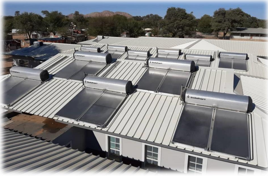
Vooruitsig School in Rehoboth, 47x 300L Solahart geysers
